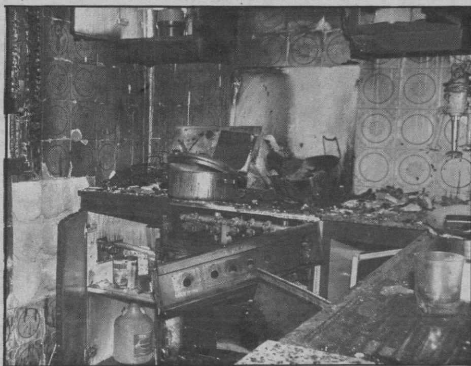
Un ángulo de la cocina incendiada, apreciándose en la fotografía de «Pascual» el estado en que quedó la misma
