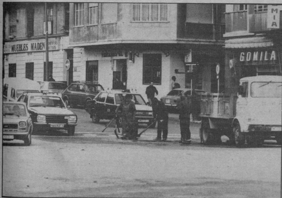
Primera hora de la mañana de ayer. En las Avenidas, junto a la puerta de Sant Antonio, justo en el momento en que más tráfico había, se realizan unas pequeñas obras en el asfaltado. El atasco se produjo.
