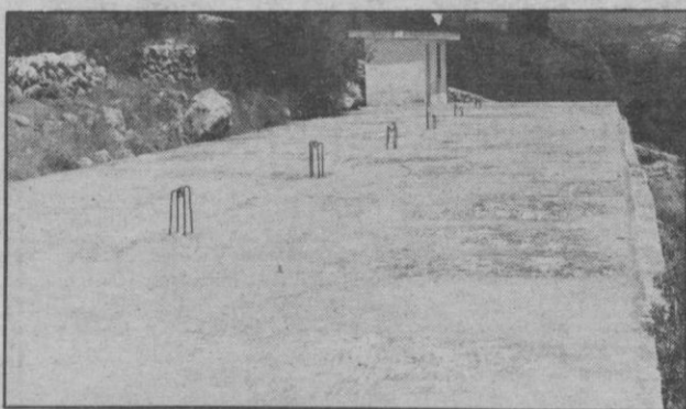
Depósito de agua de la «Fontseca», que ha resultado insuficiente para atender a toda la urbanización
