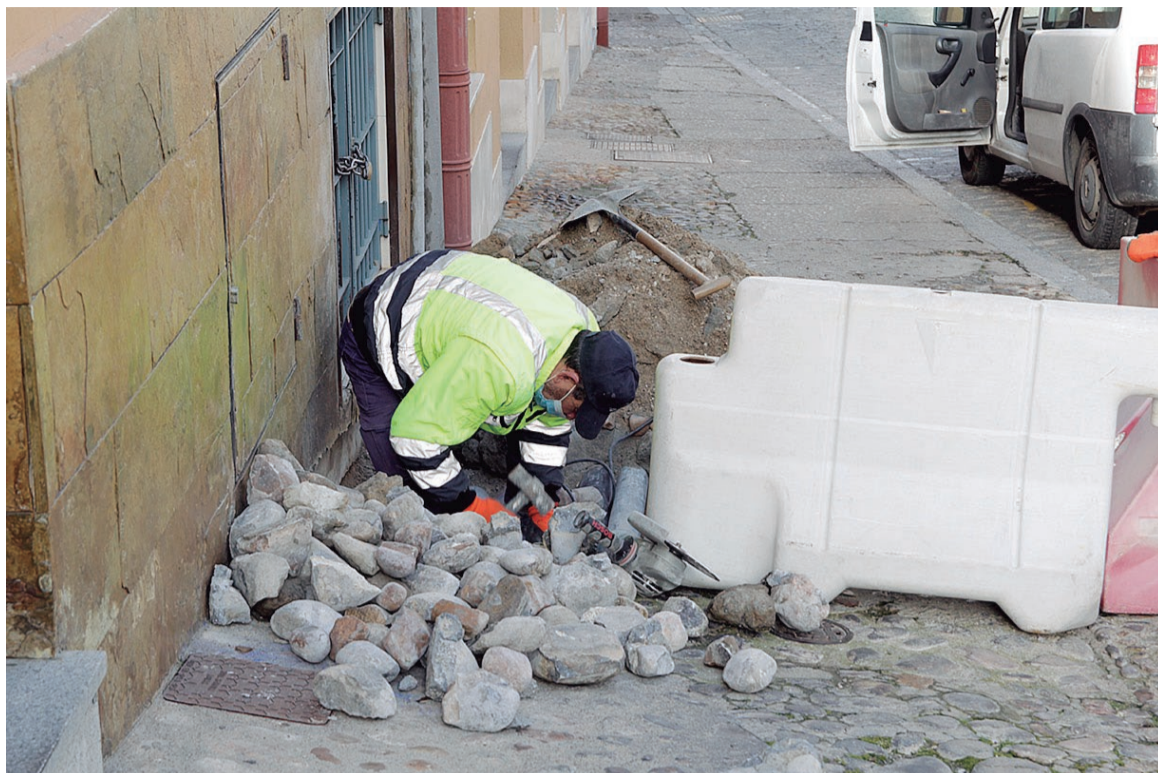
Un operario municipal trabaja en la avería que se produjo en la calle de Teodosio el Grande.
