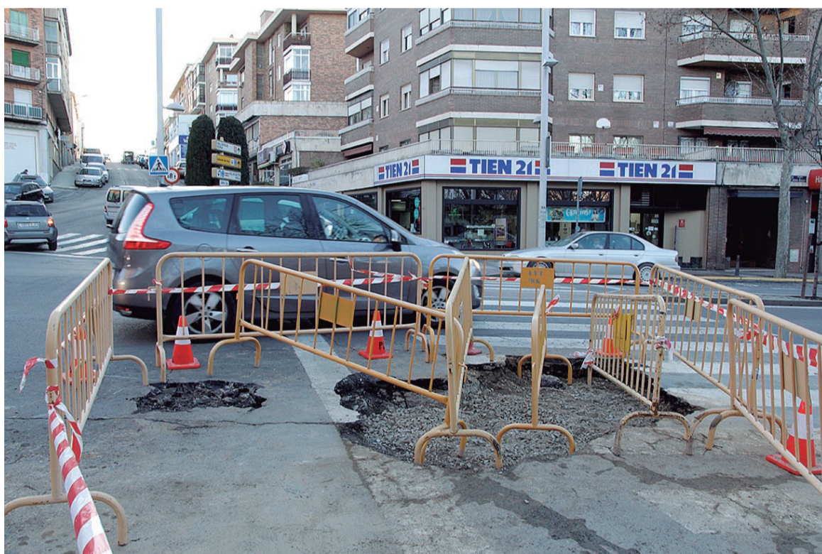
La rotura de una tubería en Ezequiel González, motivó un hundimiento de grandes proporciones.
