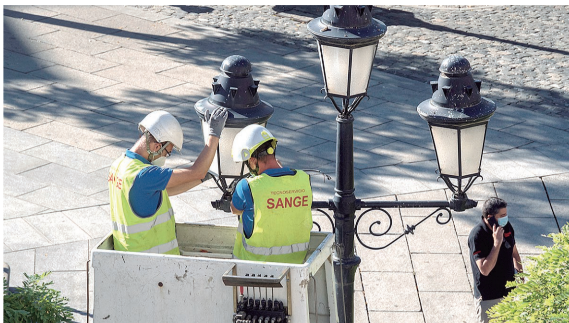
Sustitución de luminarias en la zona de la elipse a finales del pasado mes de agosto.
