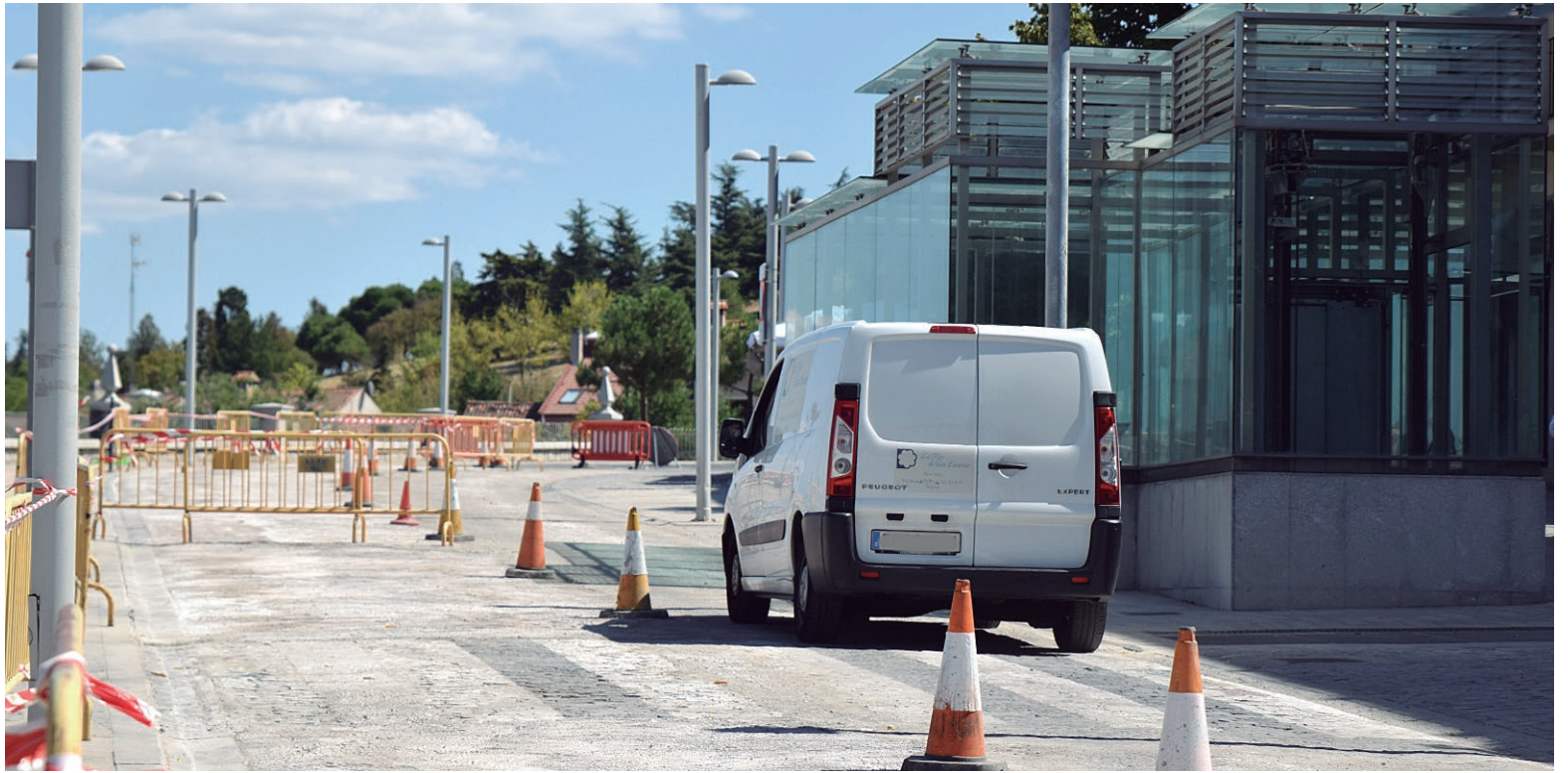
El fin de semana este tramo de la avenida Padre Claret permaneció cerrado todavía para asegurar el endurecimiento y fraguado de lechadas.
