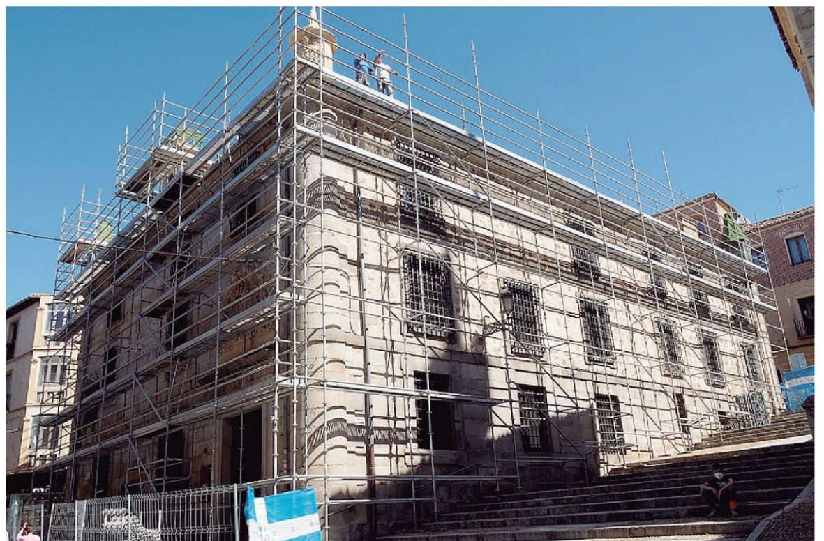
Los andamios cubren la Casa de la Lectura para su rehabilitación exterior.
