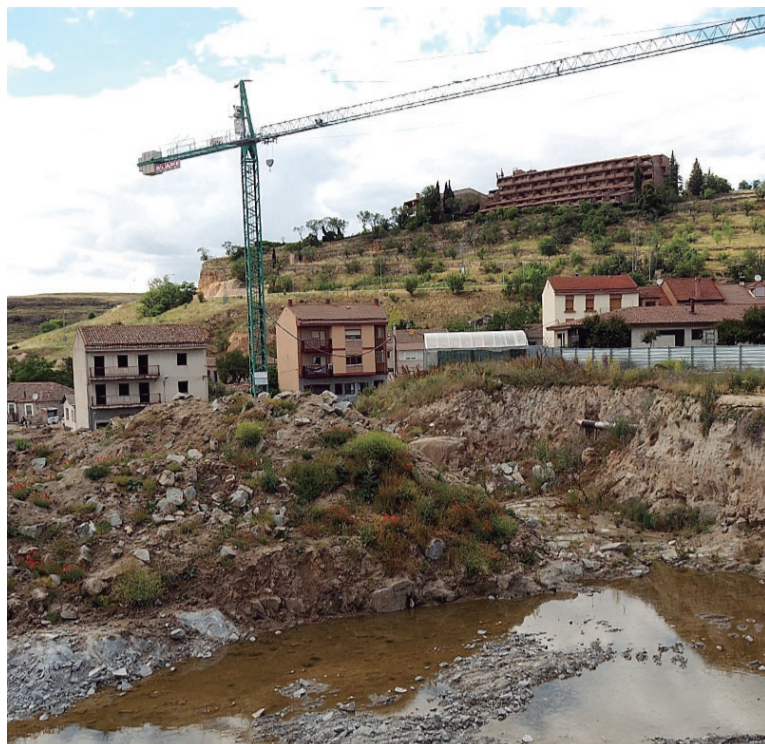
Terreno encharcado donde se construye el centro educativo.
