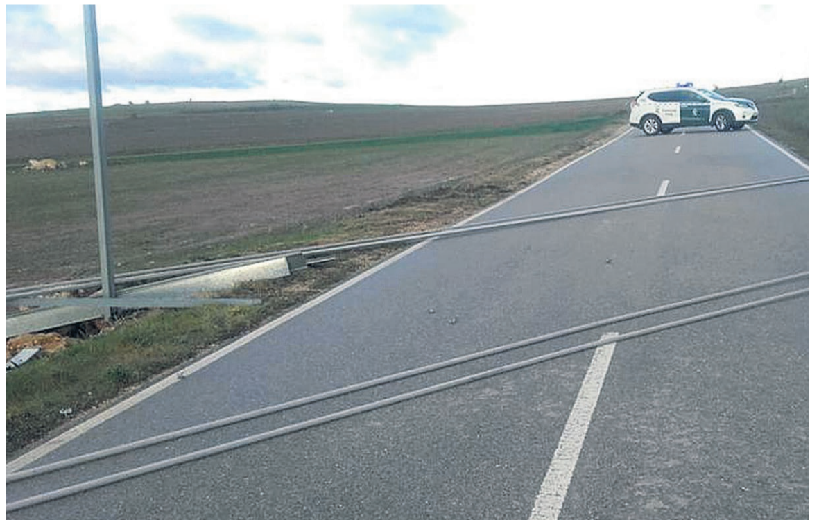
Imagen de los cables de alta tensión sobre la carretera que une Urueñas con Valle de Tabladillo.
