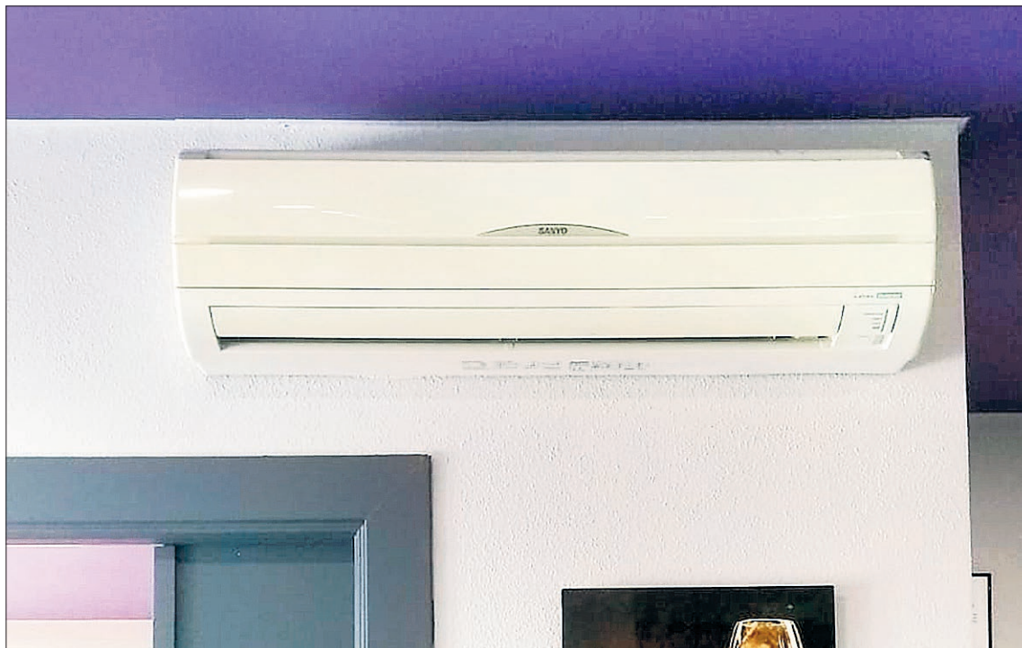
La implantación de aparatos de aire acondicionados es más habitual en las viviendas en alquiler. / EL ADELANTADO
