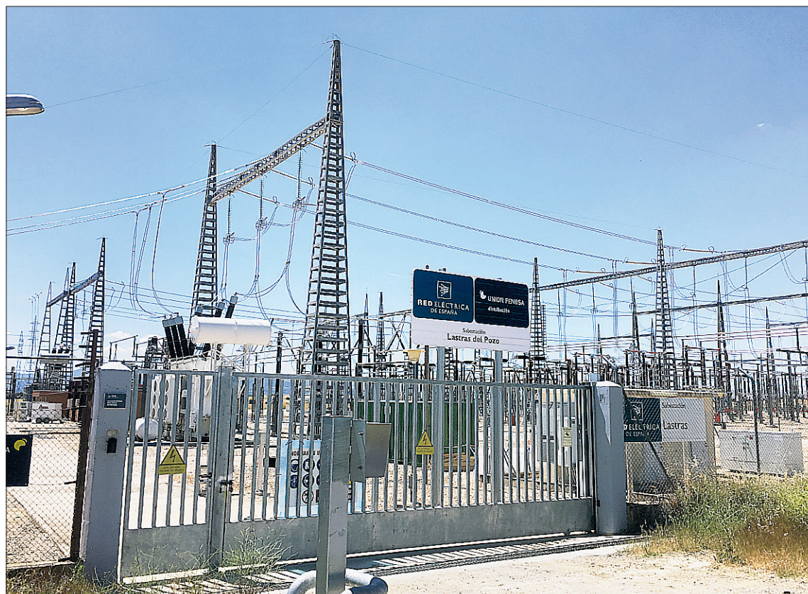
Subestación eléctrica ubicada en Lastras del Pozo y que colaborará con la futura planta fotovoltaica. / LUCÍA LUQUE
