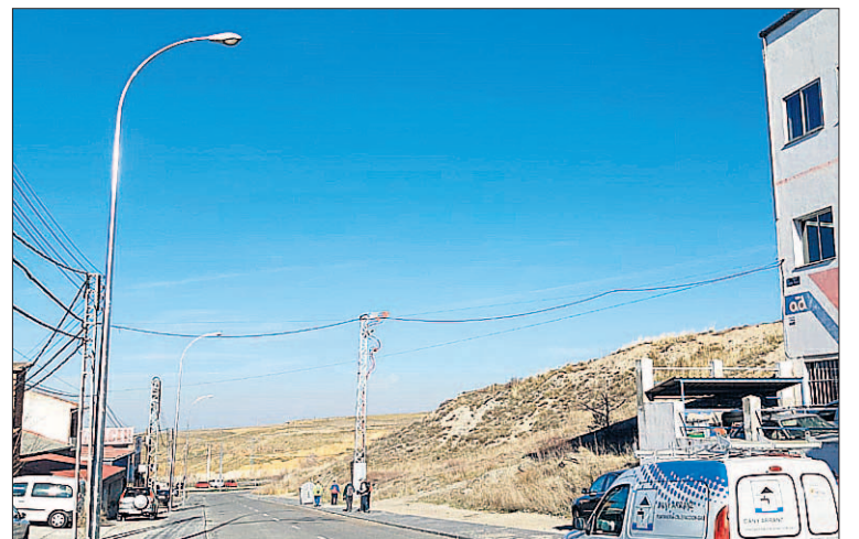
Los trabajos de renovación han comenzado en algunas de las calles. / EL ADELANTADO
