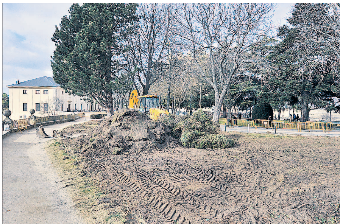
Los parterres ajardinados han sido ya eliminados para comenzar los trabajos. / KAMARERO
