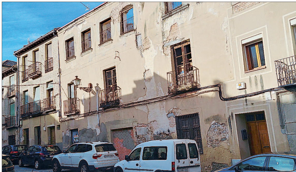
Edificio en ruinas con fachada a la plaza de San Justo, en un solar que da a la calle Alamillo. / E. A.
