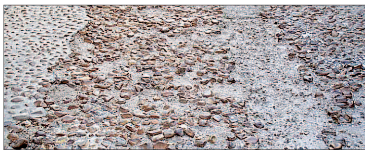
Detalles del estado en el que se encuentra la calle Mal Consejo. / EL ADELANTADO
