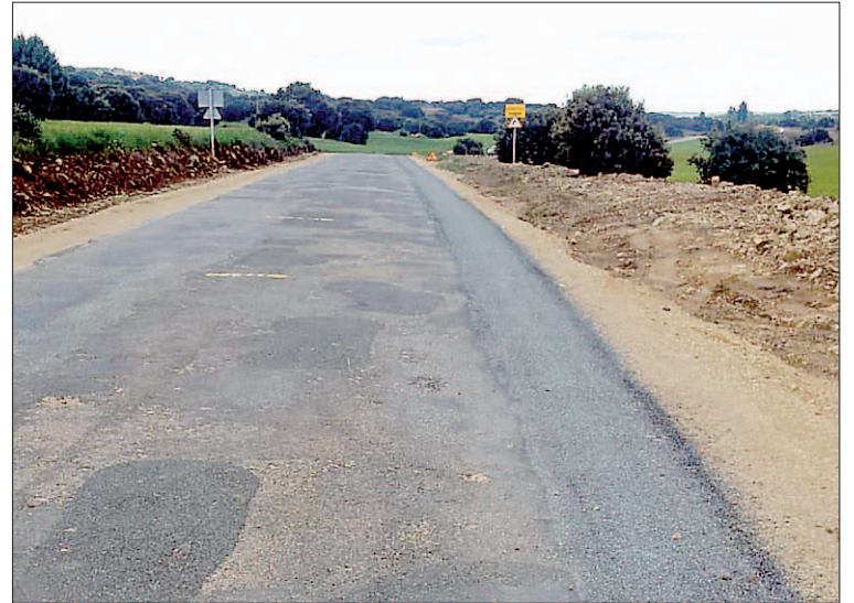
Estado actual de la vía que reparará la Diputación Provincial. / EL ADELANTADO
