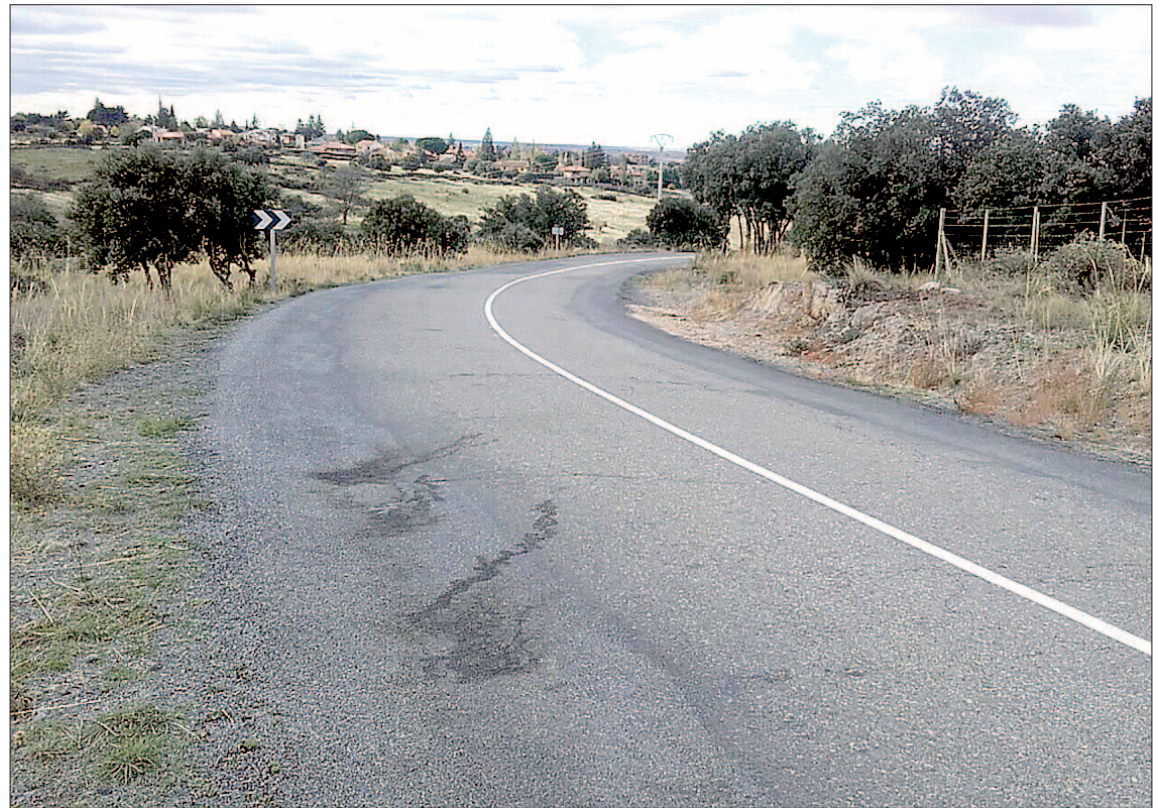
Estado actual en el que se encuentra la carretera al Palacio de Riofrío. /EL ADELANTADO
