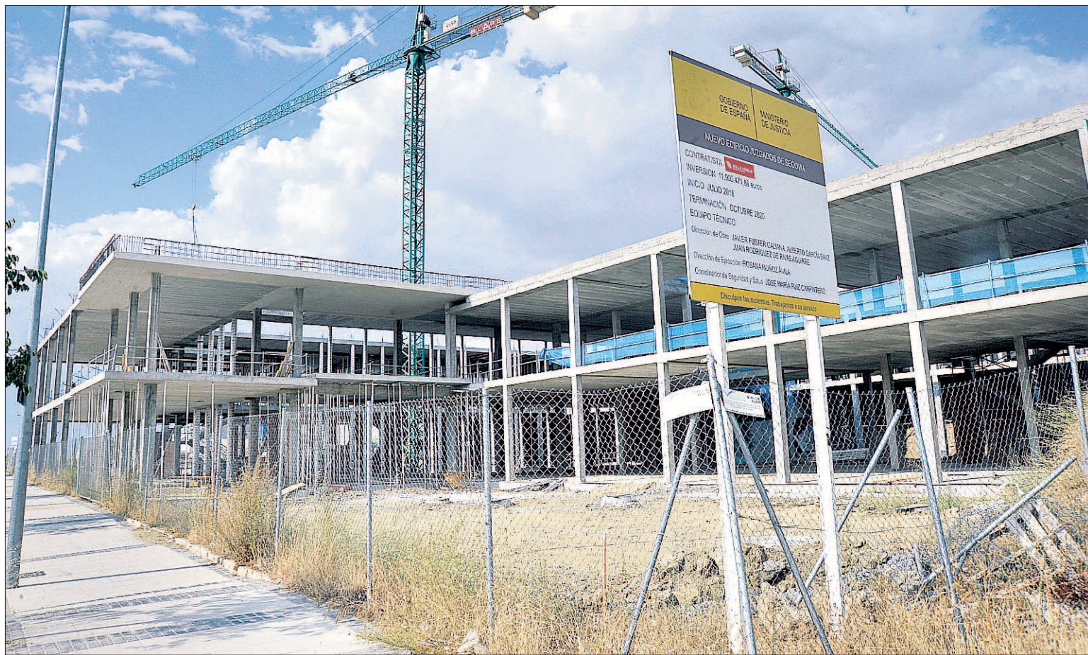
Estado actual de las obras del edificio que albergará las sedes judiciales a partir de 2020, en una parcela del barrio de Comunidad de Ciudad y Tierra. / KAMARERO
