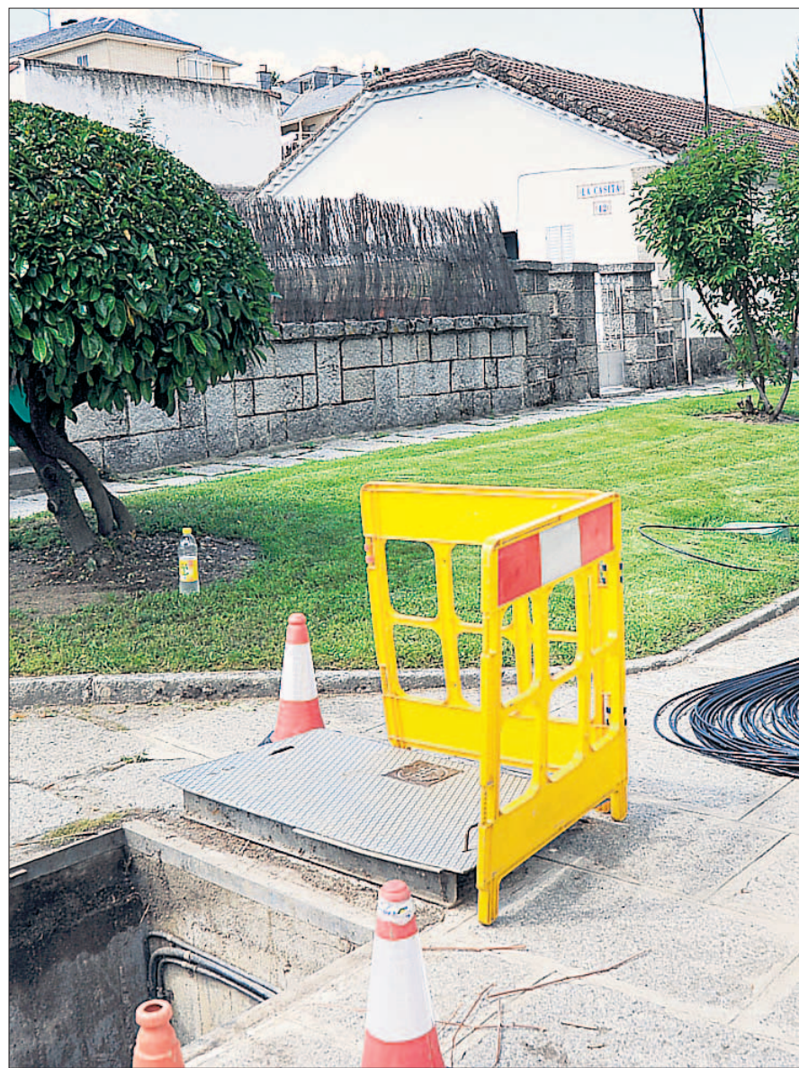
Trabajos de instalación de fibra óptica en una calle de la localidad segoviana de El Espinar. / KAM
