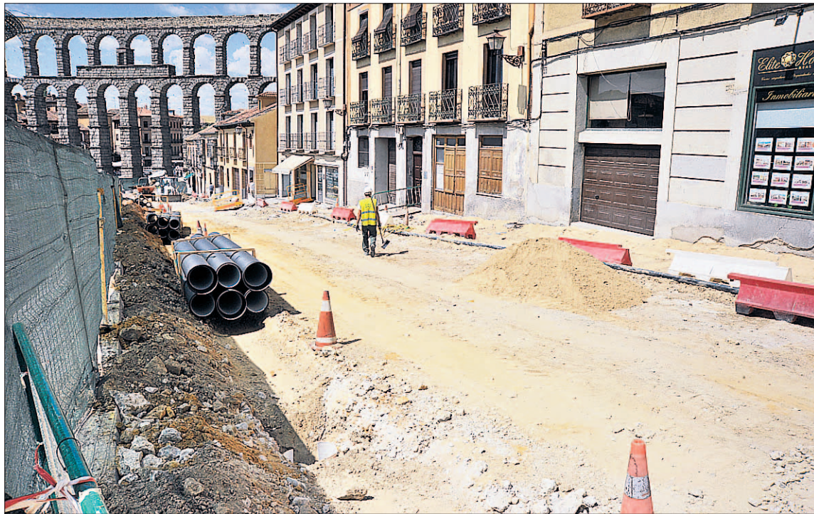
Calle San Juan, donde se ha retirado el adoquín y la losa de granito y avanza la renovación de redes. / KAMARERO
