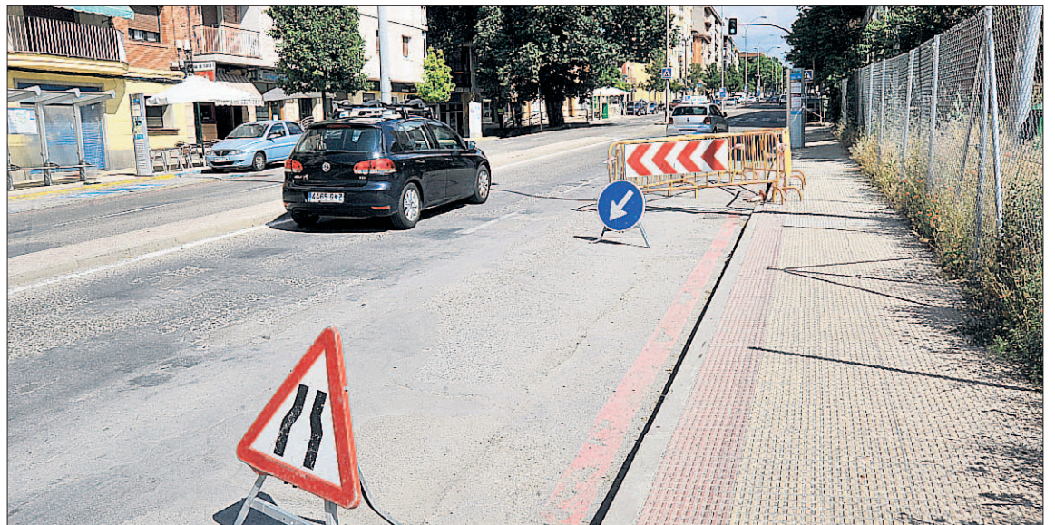
Una de las zonas afectadas por el mal estado de la red de saneamiento está señalizada para evitar el paso de vehículos. / K.
