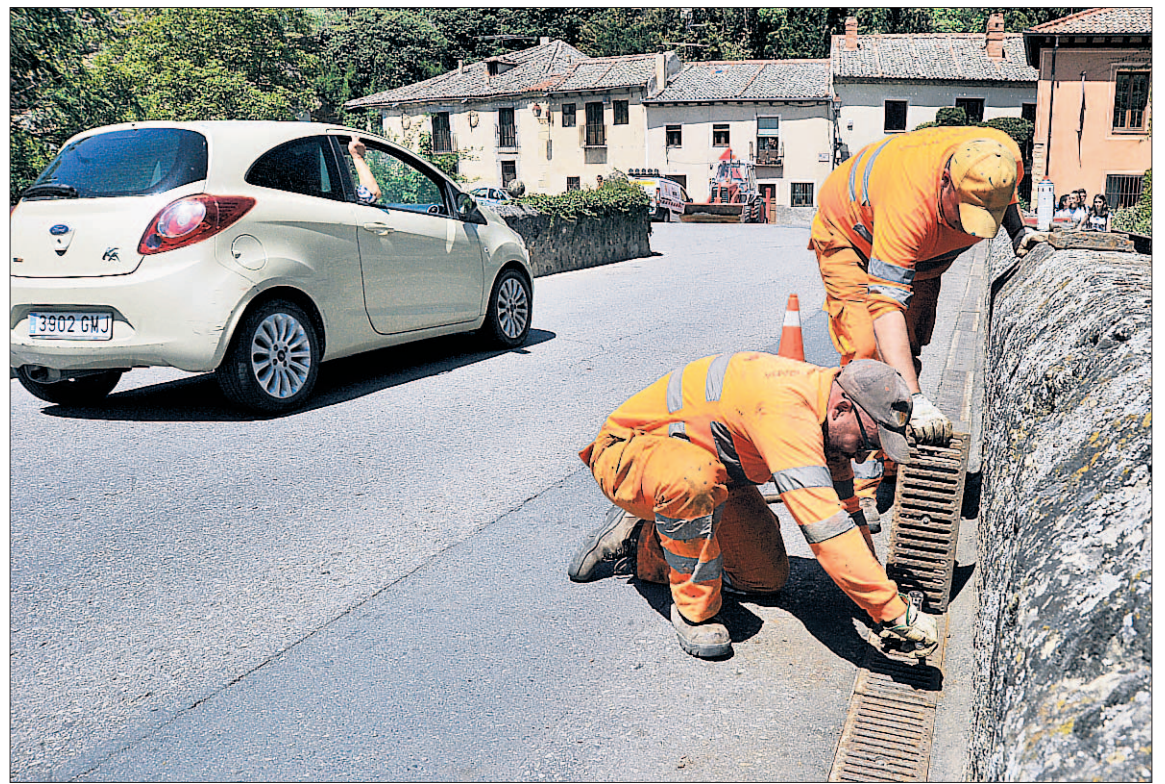
Los operarios levantaron las rejillas de las arquetas del puente para proceder a su limpieza. / KAMARERO
