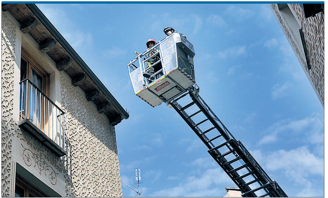
Revisión de fachada en la Calle Real. Los bomberos procedieron a revisar la fachada de un edificio de la calle Juan Bravo, junto a la plaza del Platero Oquendo, por posibles problemas de desprendimiento del revoco. Por otro lado, la Policía Local informó de dos accidentes ayer por la mañana, con daños materiales; y de una denuncia por daños en un vehículo estacionado en el parking Acueducto. / FOTO: KAMARERO
