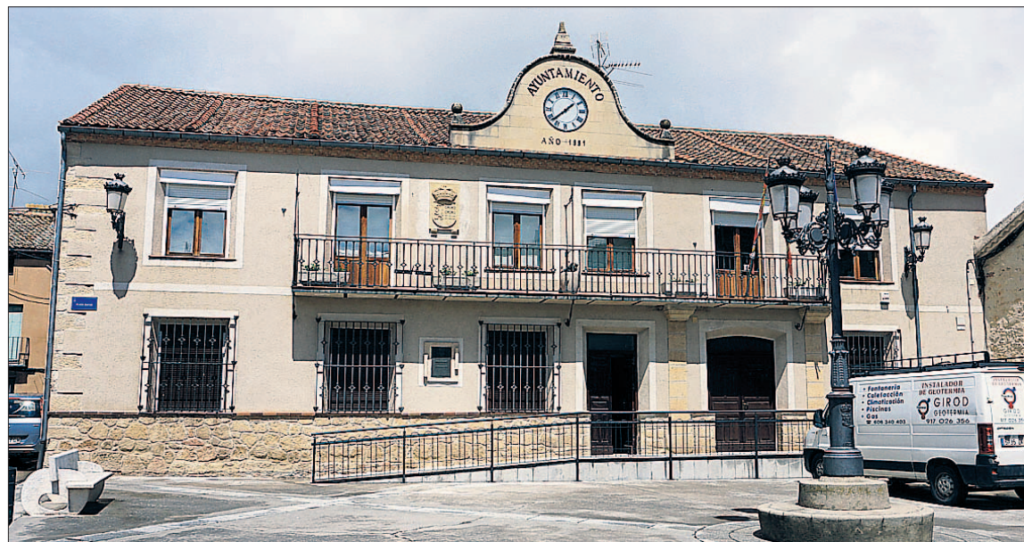
Fachada del Ayuntamiento de Bernuy de Porreros, en obras en su interior. / L.S.
