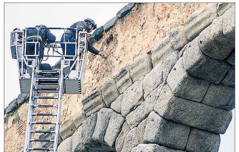
Inspección del muro de la parte superior del Acueducto el pasado febrero. / K.
