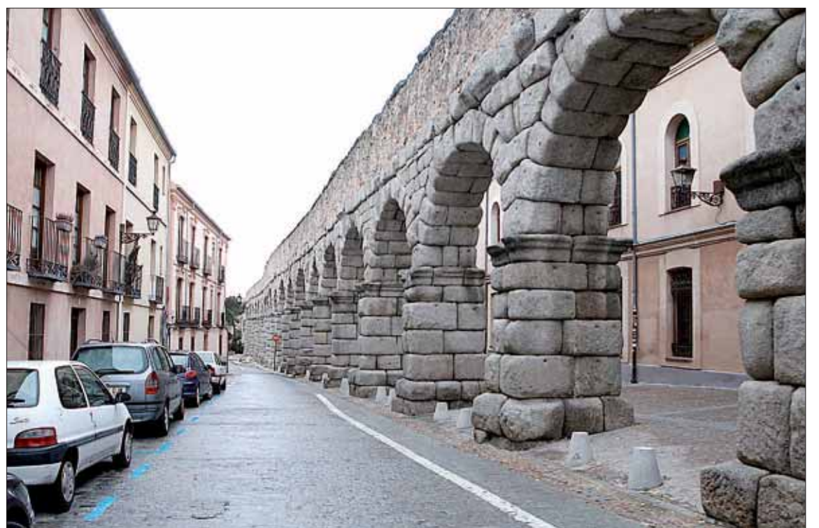
Tramo del Acueducto en la calle Almira, donde se encuentra el arco con problemas de filtraciones. / NEREA LLORENTE
