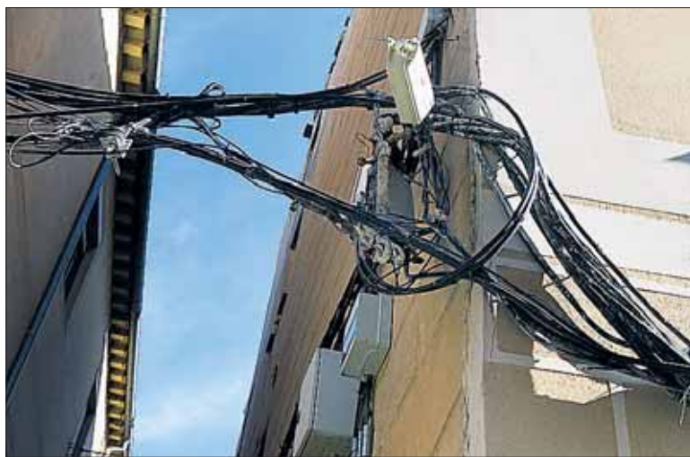
El cableado aéreo merece "un capítulo especial" para Amigos del Patrimonio. / K.
