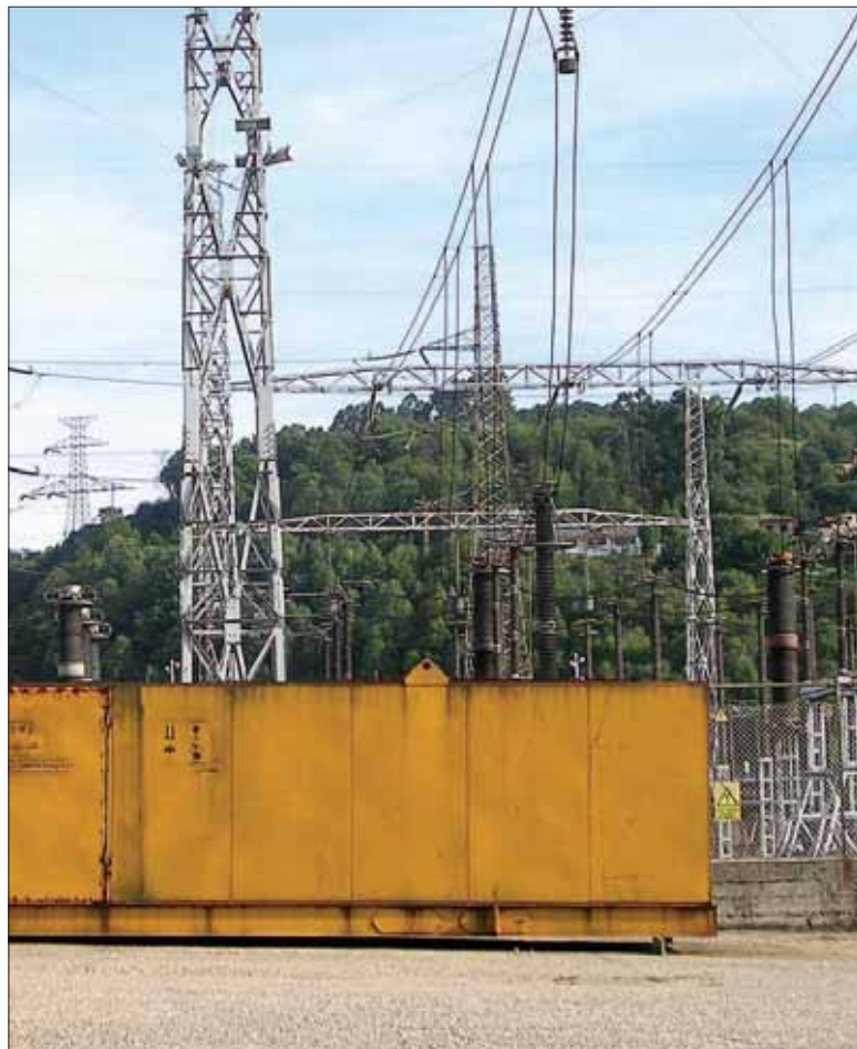
Subestación de la central térmica de Lada. / EUROPA PRESS
