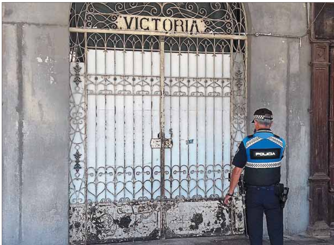
El hotel Victoria, situado en la Plaza Mayor, se encuentra en un estado de conservación ruinoso. / EL ADELANTADO
