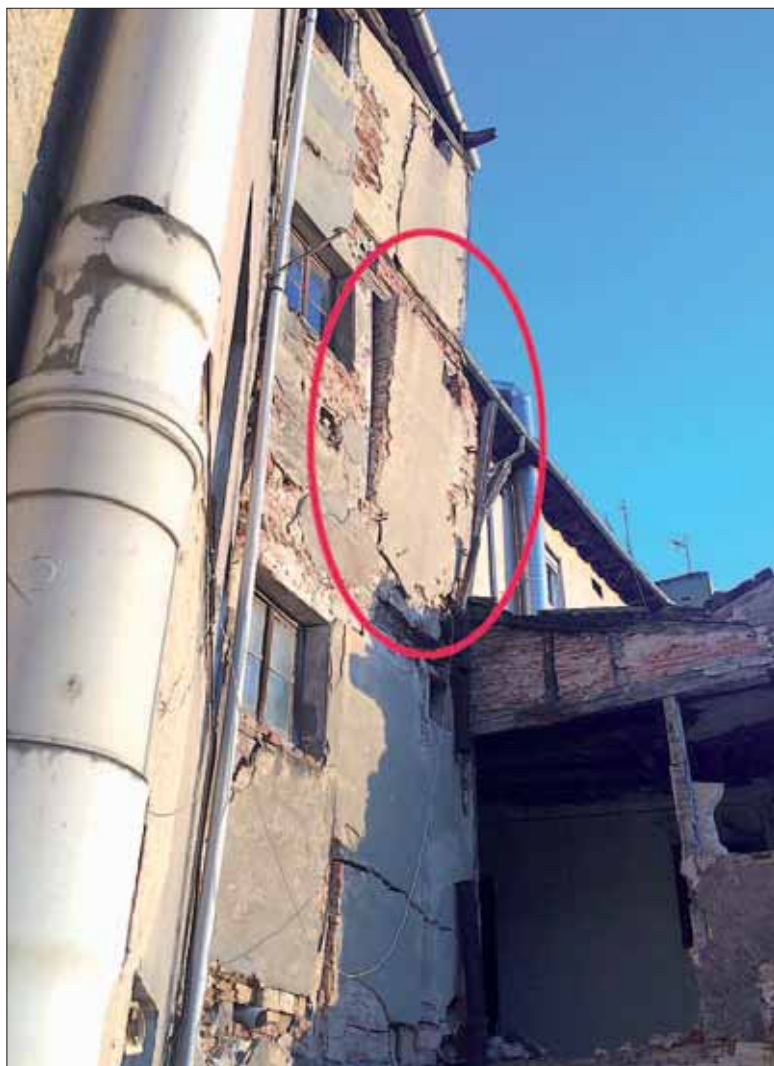
Remarcado, el lienzo de la pared interior que se derrumbó ayer. / EL ADELANTADO
