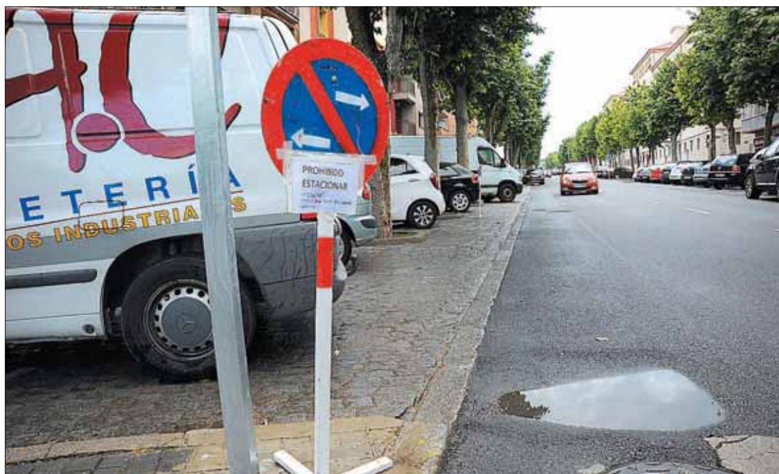
El tramo de la avenida que resultará afectado por los trabajos de reparación ya está señalizado. / KAMARERO
