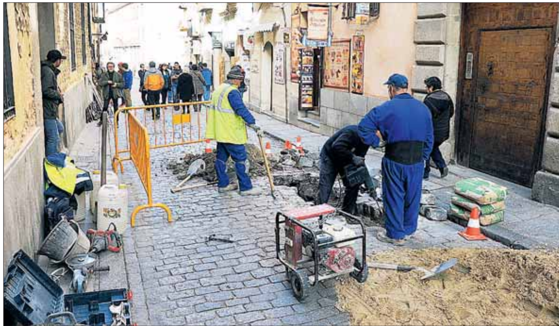
Un hundimiento en la calle Marqués del Arco obligó al Ayuntamiento a una reparación de urgencia. / KAMARERO
