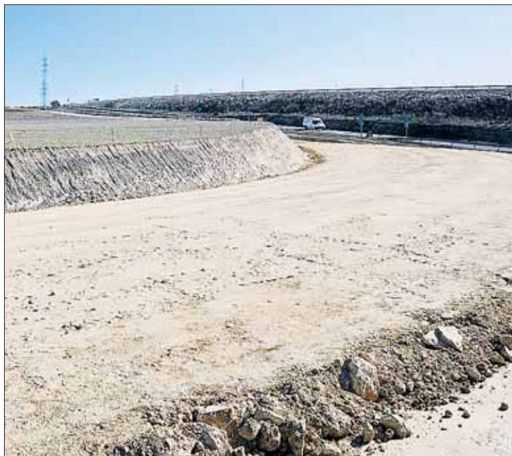
Los trabajos dejan ver ya el que será el trazado del desdoblamiento. / KAMARERO
