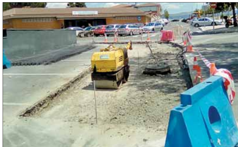
Las máquinas ya trabajan en la zona del aparcamiento lateral. / EL ADELANTADO
