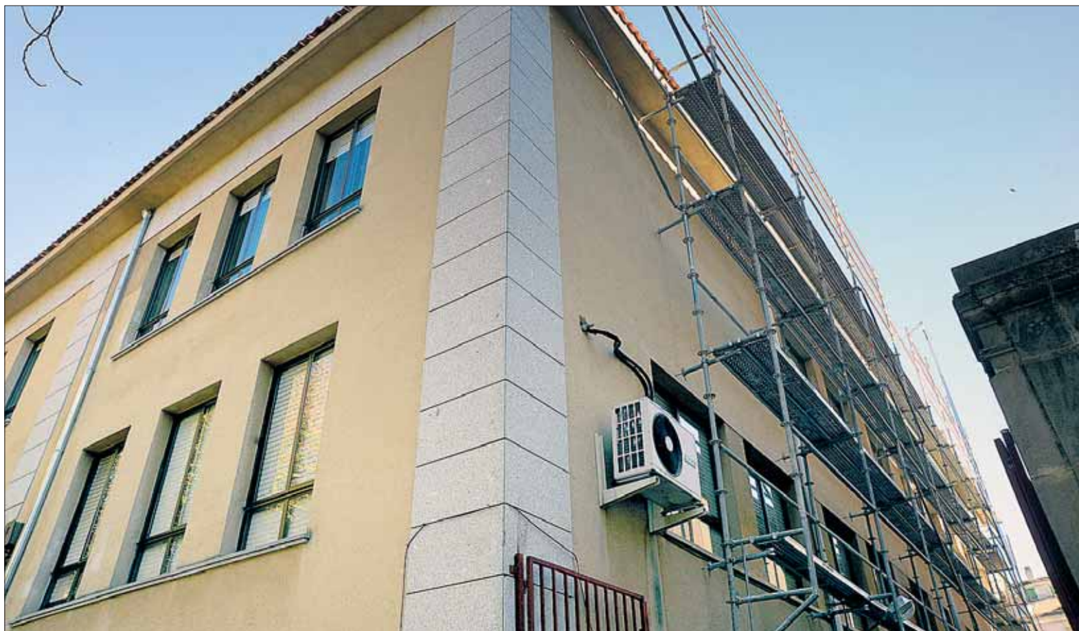
Los andamios comenzaron a instalarse el jueves de la semana pasada en este centro público del centro de la ciudad. / KAMARERO
