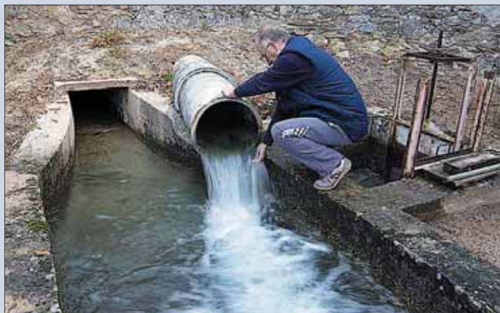
Entrada de agua del Pontón a la depuradora, en imagen de archivo. / J.M.
