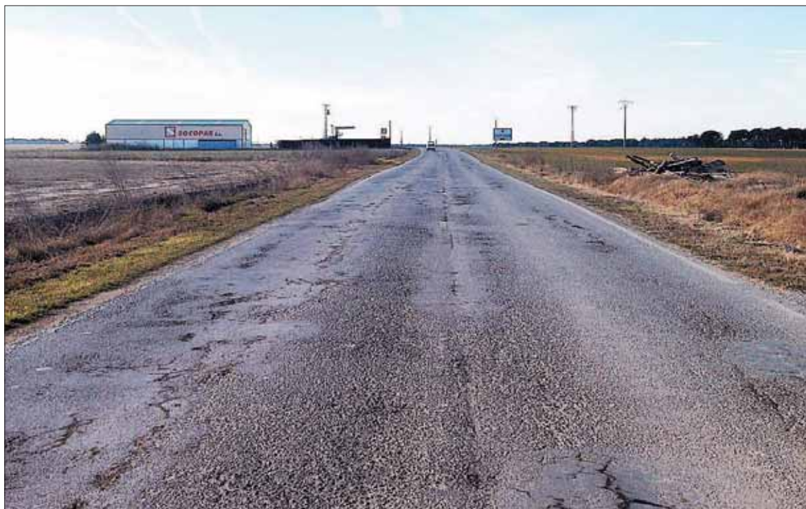
Las obras están relacionadas con las reparaciones de redes de servicios públicos y arreglo y reparación de vías públicas. /EA
