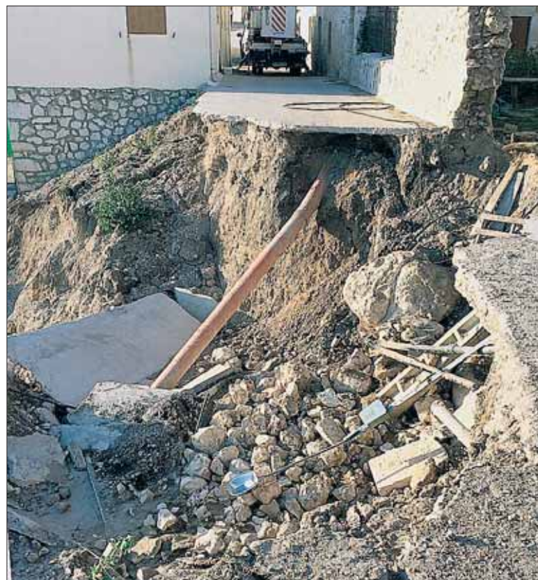
Aspecto del hundimiento de la calle Barriónuevo. / EL ADELANTADO
