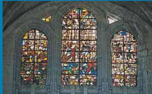
Vidriera en mal estado de la Catedral de Segovia.
