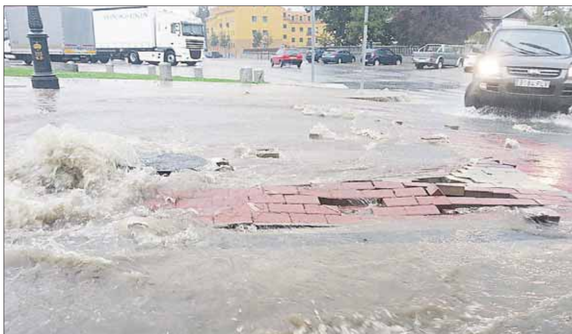
Alcantarilla levantada por la fuerza del agua en un paso de peatones de una calle de El Real Sitio de San Ildefonso. / A. MUÑOZ
