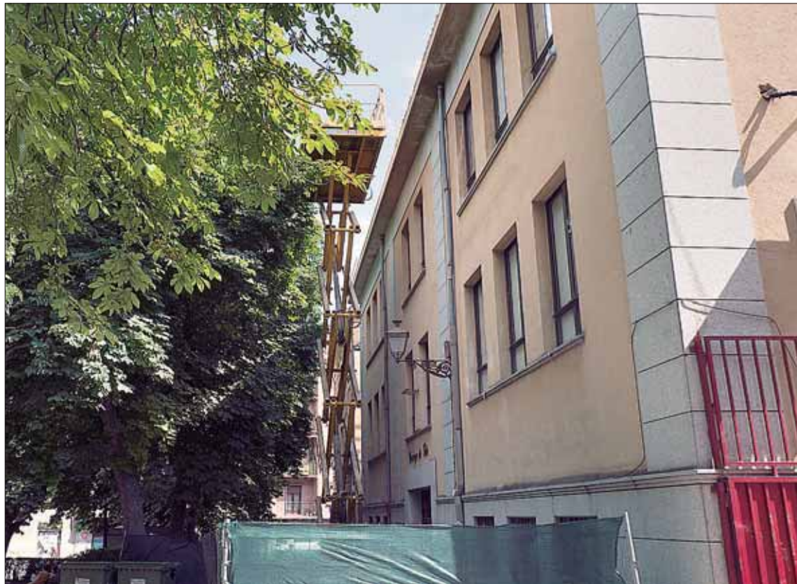
Los andamios para reparar la cubierta están situados cerca de la fachada del colegio Domingo de Soto. / KAMARERO
