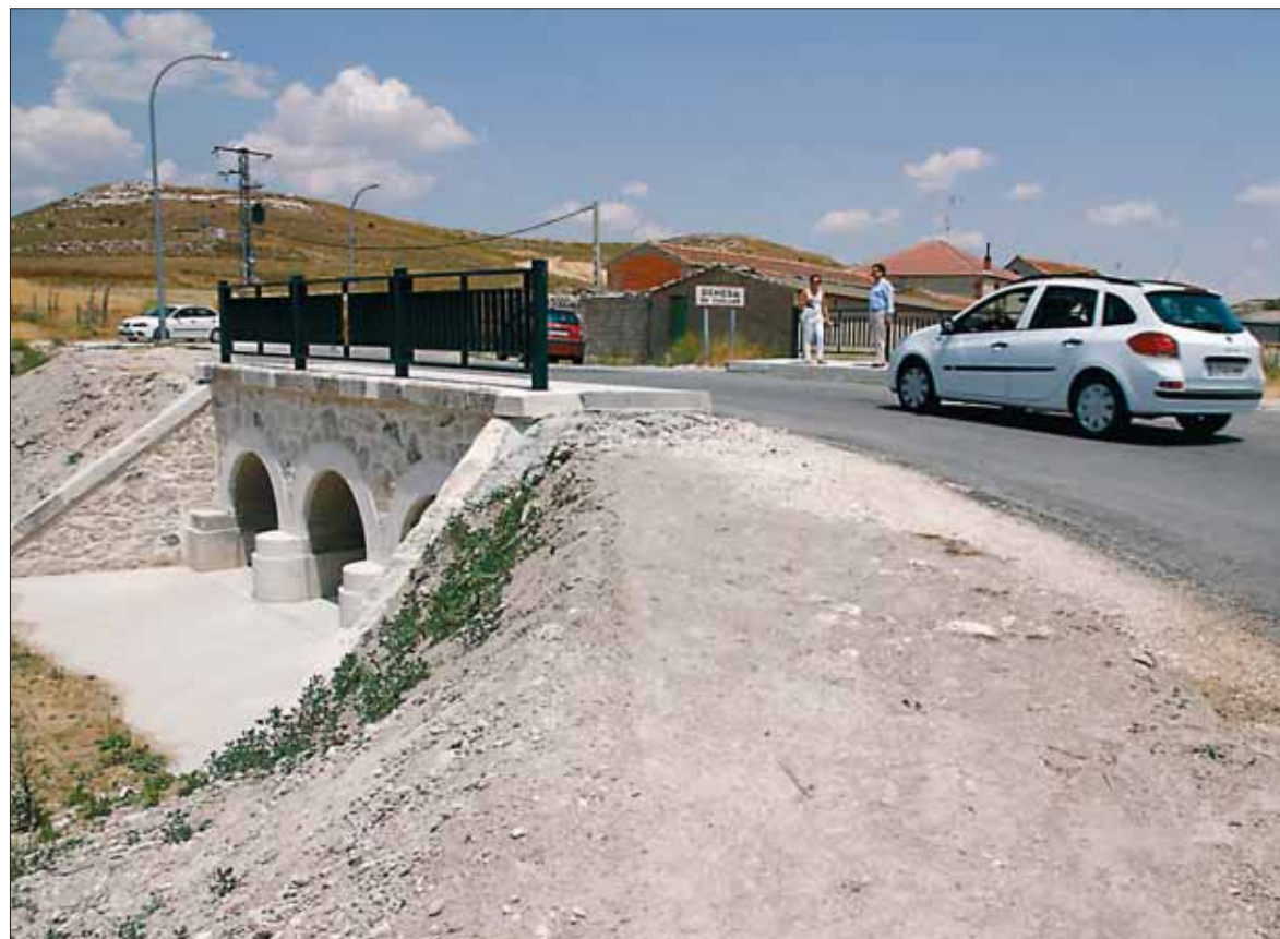
La ampliación del puente sobre el arroyo Collalbillas destaca en los trabajos realizados hasta el momento. / GABRIEL GÓMEZ
