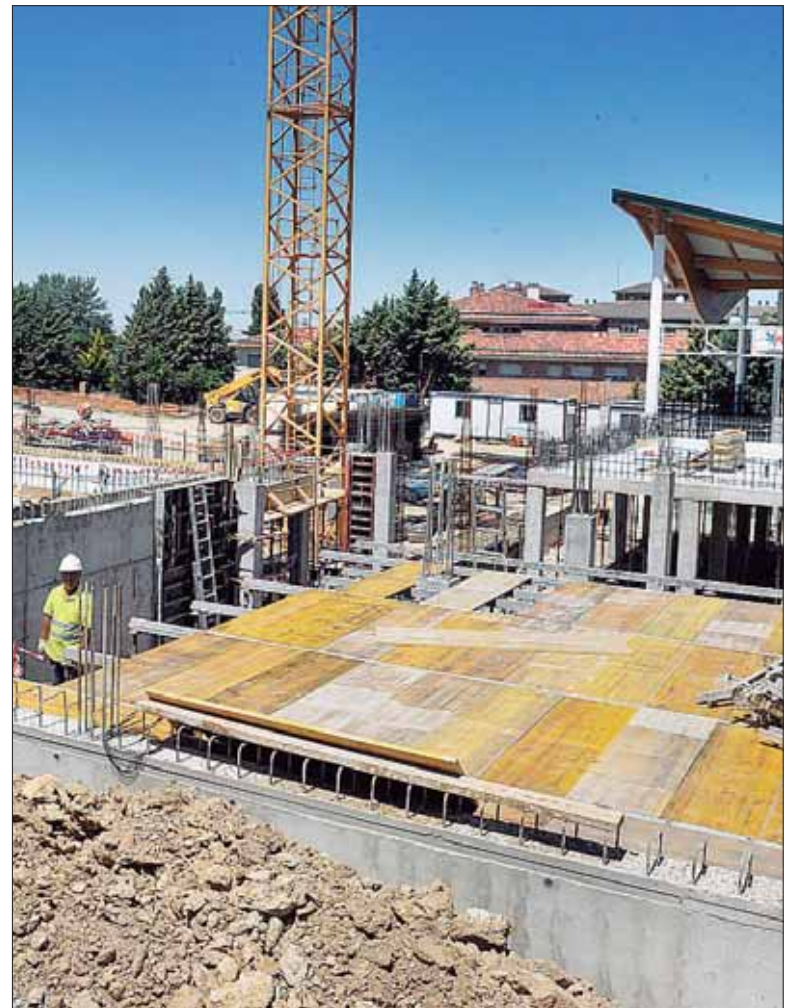
Estado de las obras de la segunda fase del complejo Carlos Melero. / KAMARERO
