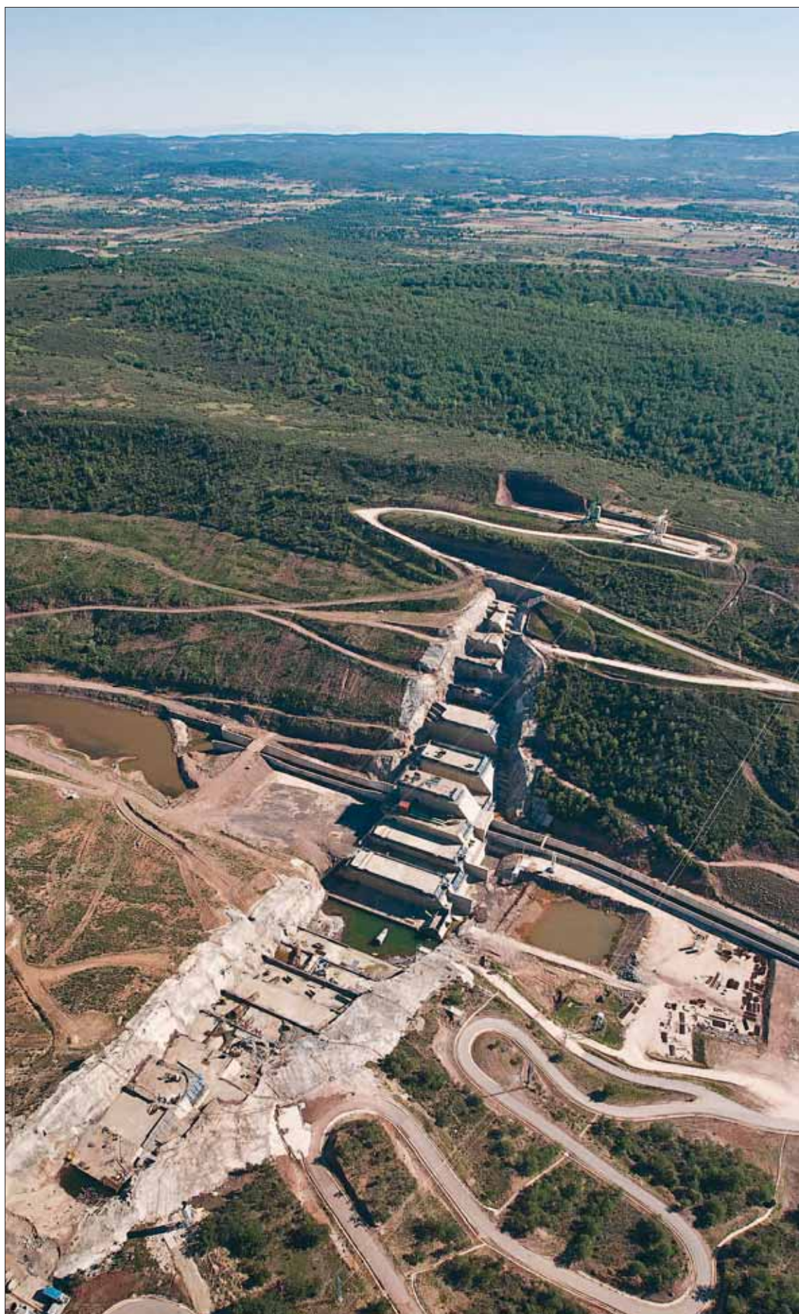
Estado en el que se encuentran las obras de la presa de Castrovido en Burgos. / ALBERTO RODRIGO
