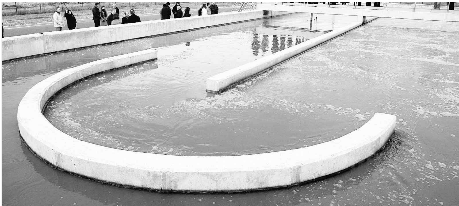
La CHD invertirá 630.000 euros en la estación depuradora de Tordesillas. /RUBÉN CACHO (ICAL)
