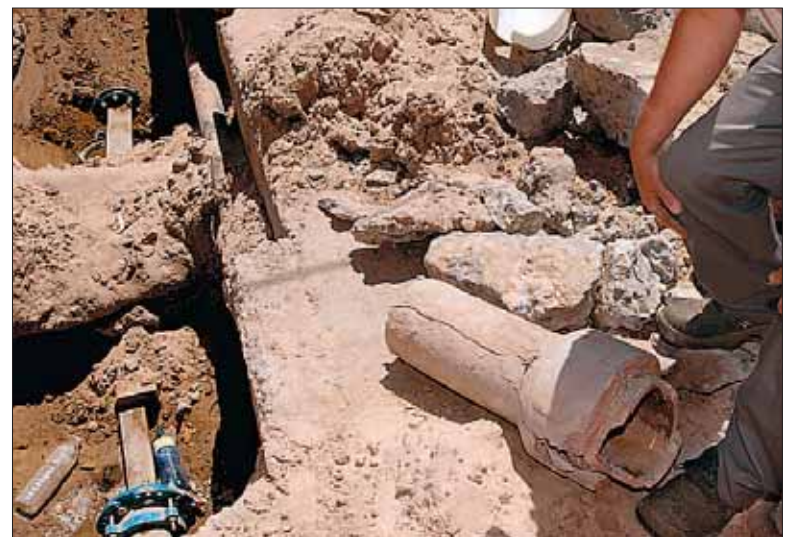
La rotura de tuberías es muy frecuente en Sanchonuño. / LARA MAZAGATOS
