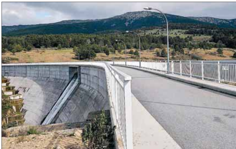
Presa del Ceguilla. Aguas de la Cuenca Norte ha licitado obras para ampliación de su sistema de auscultación. / KAMARERO
