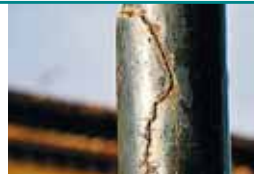
Las grietas afectan a los pilares que sujetan la cubierta del kiosco.
