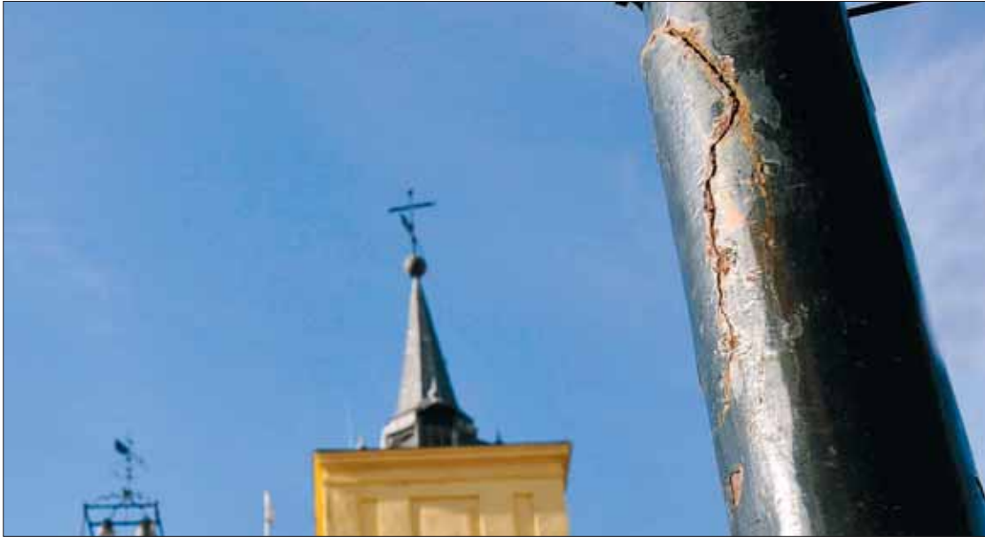
Algunas de las grietas tienen apreciables dimensiones. Al ser columnas huecas, ejercen la función de bajantes del agua de lluvia. / JUAN MARTÍN
