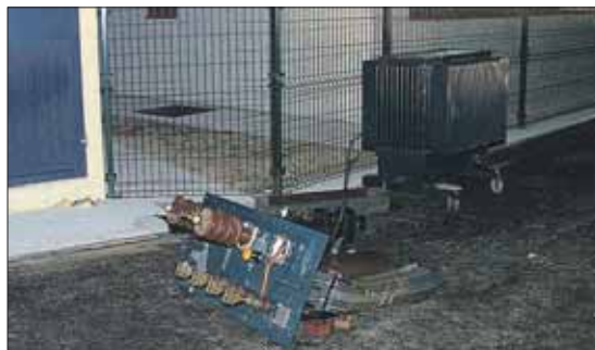
El transformador de la depuradora fue robado el fin de semana. / G. HERRERO
