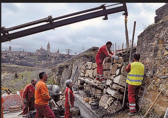
La Diputación trabajaba a finales de marzo en el arreglo de este muro de contención de la subida de Zamarrama que había sufrido un desprendimiento.
