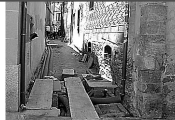
Imagen de las obras que se ejecutan en la Travesía de Canonjías.
