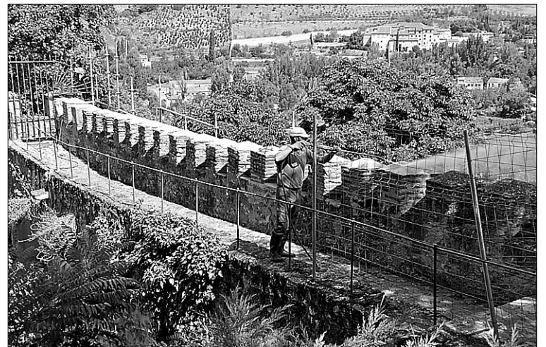
Limpieza de la muralla en el entorno de la Puerta de San Cebrián. //JUAN MARTÍN
