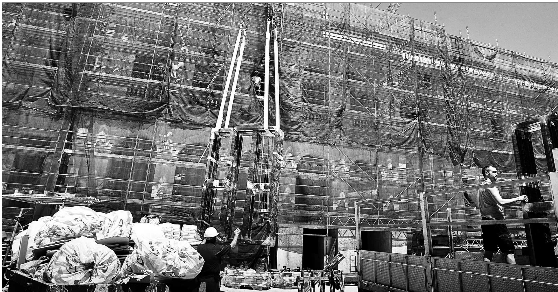
Obras de rehabilitación del Palacio de Justicia, sede del Tribunal Superior de Justicia. / TOMÁS ALONSO
