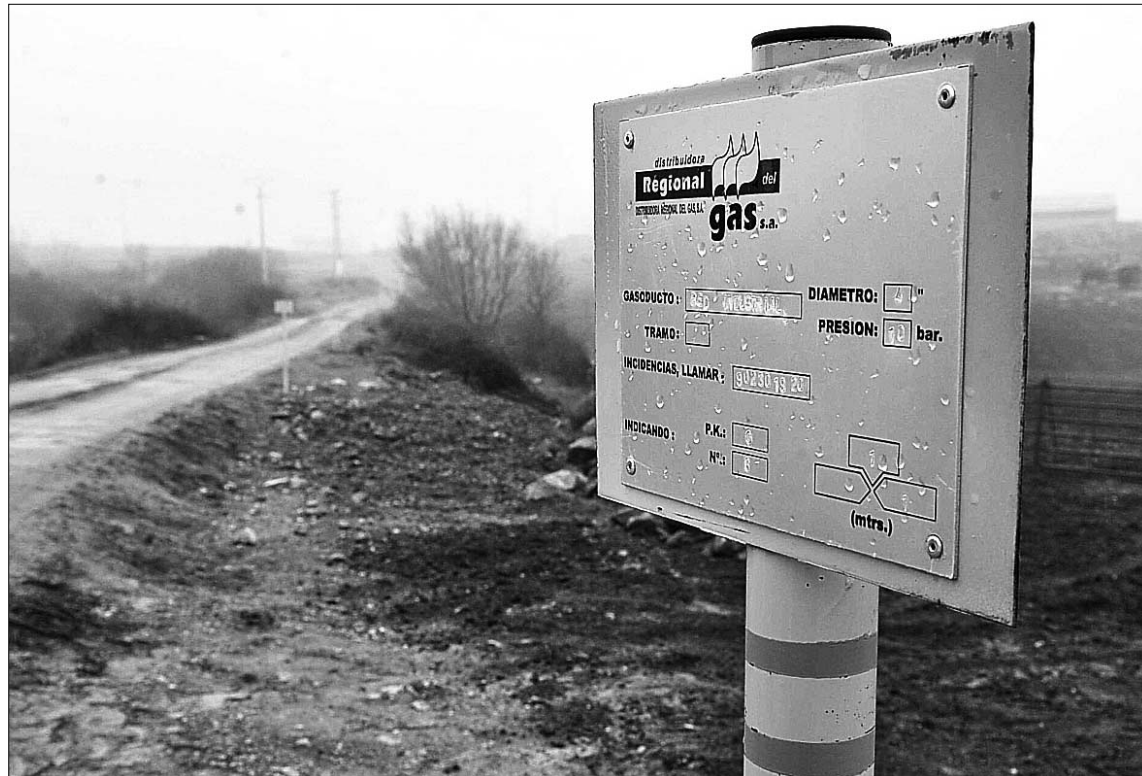
Poste del gaseoducto Ávila-Segovia, que permitirá llevar el gas a estas cuatro localidades. / KAMARERO
