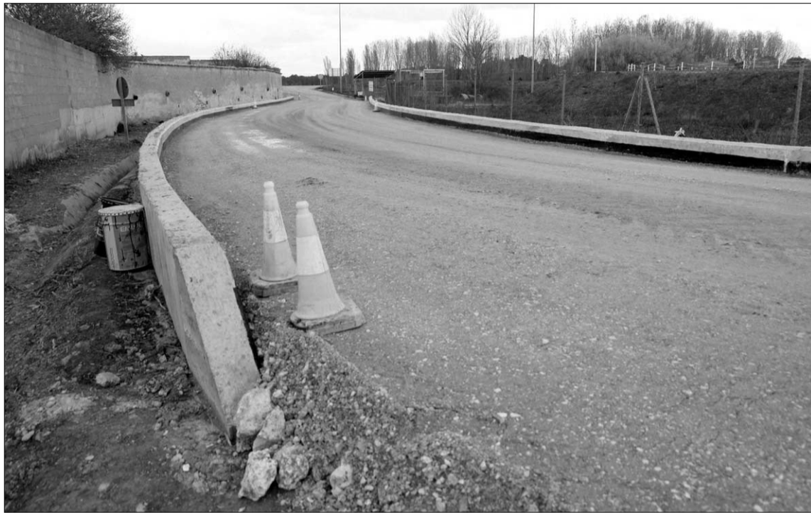
Zona del camino del Salinero en la que se ha realizado un muro de hormigón a ambos lados. /GABRIEL GÓMEZ
